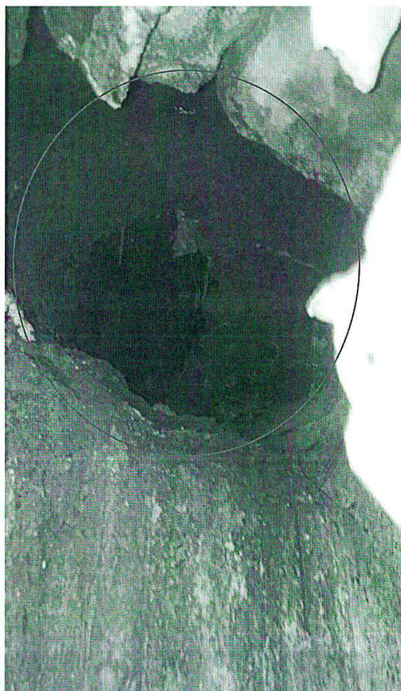
Vecchia canna fumaria dismessa riscontrata nell'intercapedine
